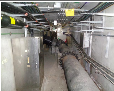
의사당로B 통신구 내부 전경
