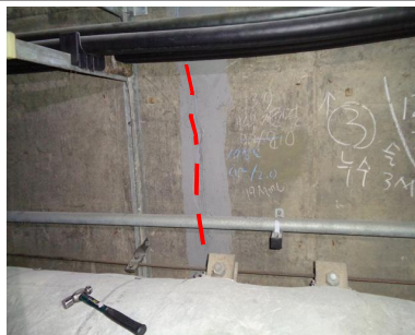
전력구 횡방향 재균열(cw=0.2mm)
