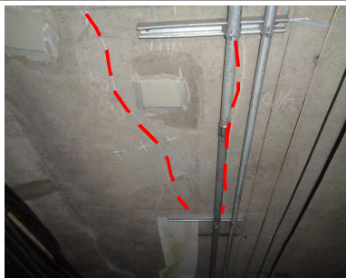
전력구 종방향 균열(cw=0.2mm)
